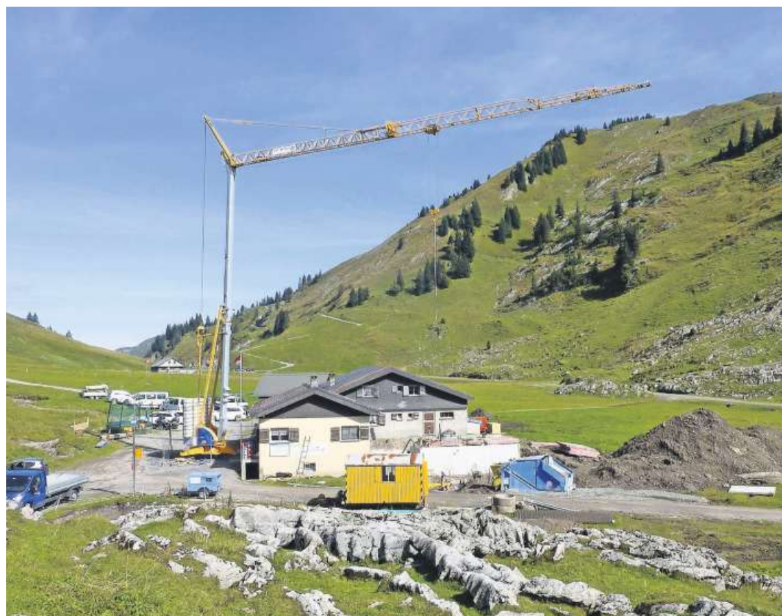
Auf dem Pragelpass wird betoniert. Nächstes Jahr wird die Alpwirtschaft teilweise abgerissen und erweitert. Bild: Franz Steinegger
